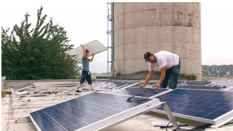
Auf der Dachfläche des Betriebsgebäudes wurde die PV-Anlage mit 37,49 kWp installiert. Weitere wirtschaftliche Standorte auf dem Betriebsgelände für Photovoltaik wurden ebenfalls genutzt und ergeben so eine Gesamtleistung von ca. 41 kWp.
